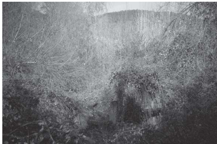
Presa con maleza antes de su limpieza
