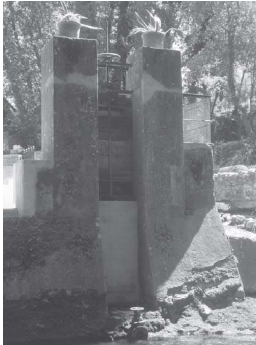
Presa de regulación, una vez realizados trabajos de restauración y dotada de nuevo de la movilidad de antaño
