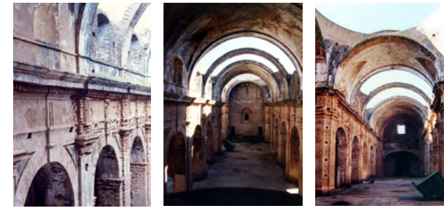
Interior de la Iglesia Inacabada en 1991. Detalle de los muros con efecto “panal”. (Fotos: ANFV).
